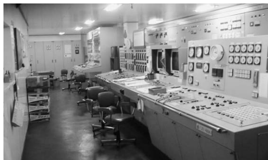
▲機関コントロールルーム操縦盤
