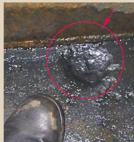
【写真1】貨物タンク底面に発生するピット(通常鋼)
