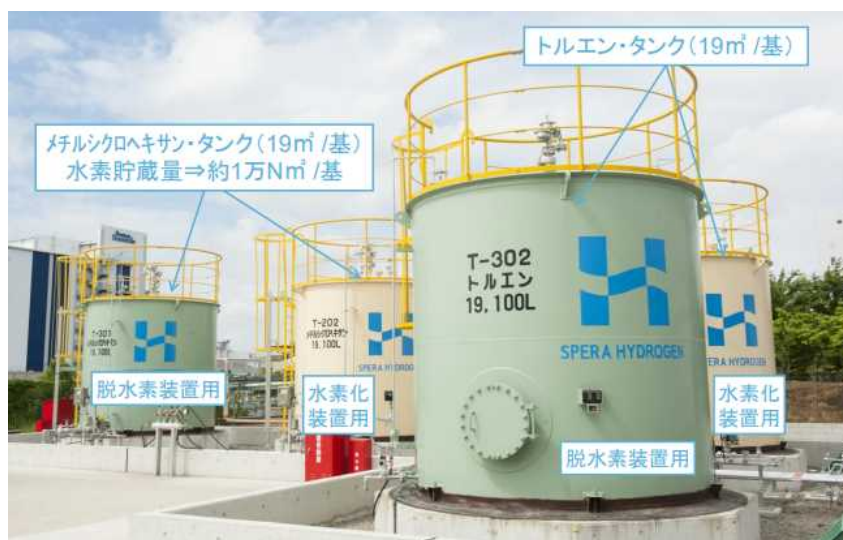
資料:「SPERA 水素 千代田の水素供給事業」、千代田化工建設株式会社 図 10:有機ハイドライドタンク(実証段階)
