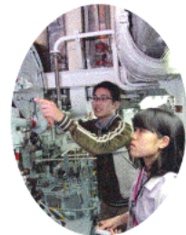
エンジンルームの設備について説明を受ける
